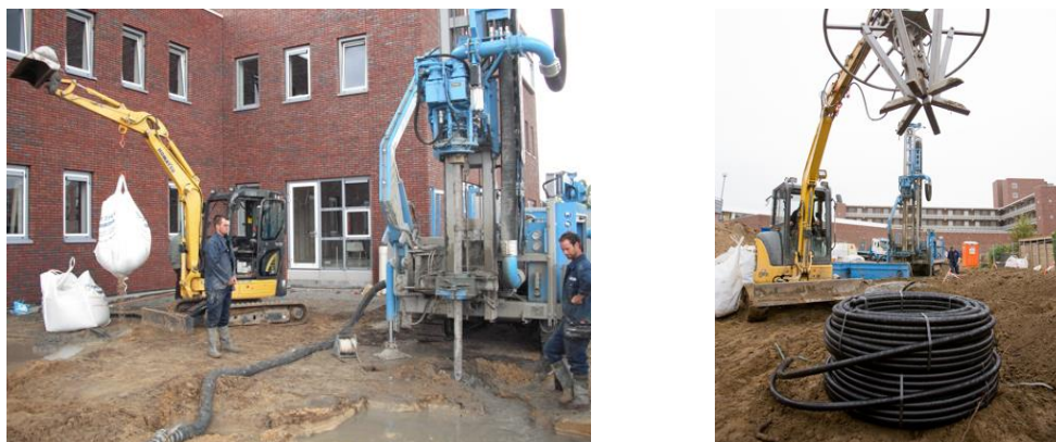
Figuur 7.5 | Installatie bodemwarmtewisselaars. Links boring, rechts de gesloten lus voordat deze de grond in gaat.
