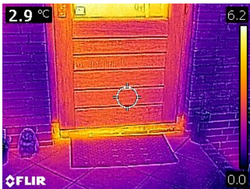
(onderzijde tuindeur lekt warmte)
