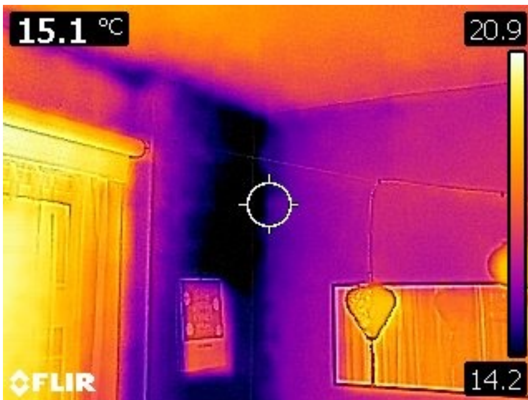
ONGEÏSOLEERDE SPOUWMUUR VERLIEST VEEL WARMTE (HOEK LINKS) IN TEGENSTELLING TOT SCHEIDINGSMUUR MET BUREN (HOEK RECHTS)
