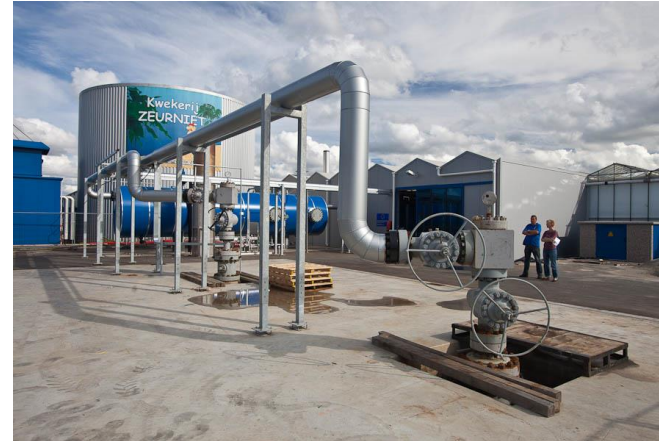
Figuur 15 - Geothermie installatie (bovengronds)
